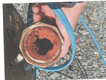
Eisenablagerung in der Leitung
